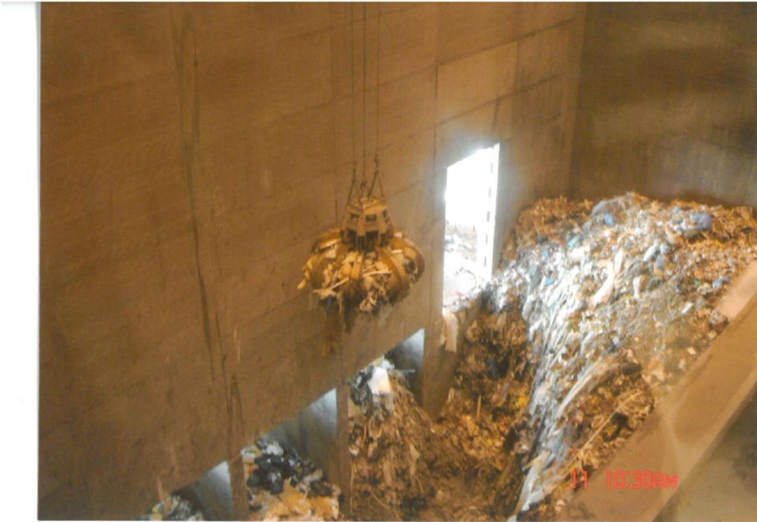
Ładowanie śmieci do komory spalania.
